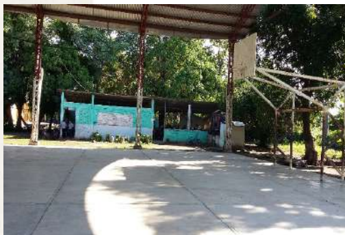
Imagen 52. Falta de mantenimiento de aulas
