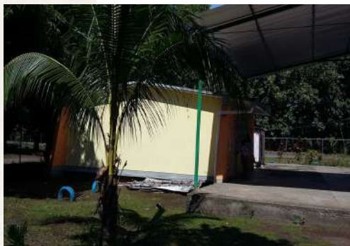
Imagen 58. Aulas con daños por sismo
