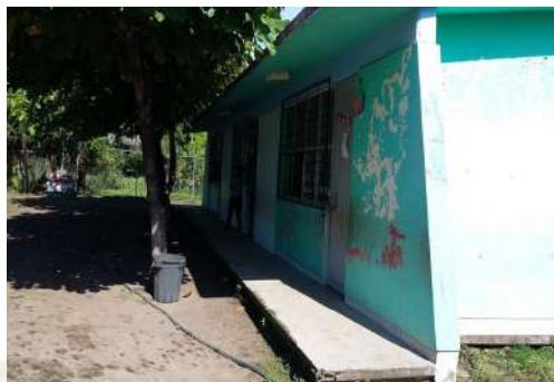
Imagen 53. Aula precaria, insegura
