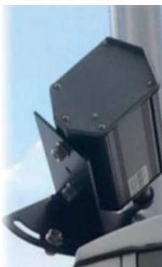
Figura 5.8. Detectores no intrusivos para intercepción semaforizada RAD-TMA122
